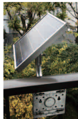
ソーラーパネル取り付け架台
